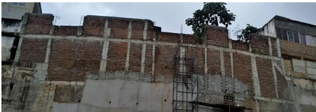
Figura 4 – Segunda estrutura após o primeiro colapso. Fonte: Acervo próprio, 2016.
