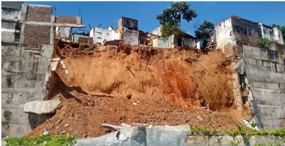
Figura 6 – Face do solo exposta após o segundo colapso. Fonte: Acervo próprio, 2016.
